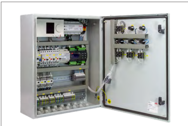
Рис. 48. Шкаф автоматизации «Данфосс»
