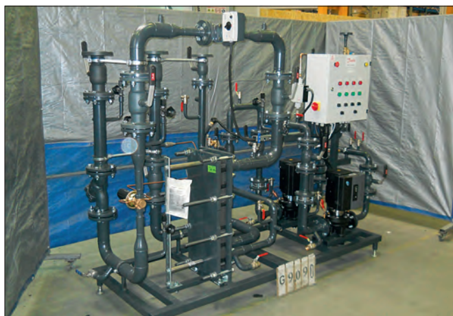
Рис. 47. Автоматизированный тепловой пункт.
