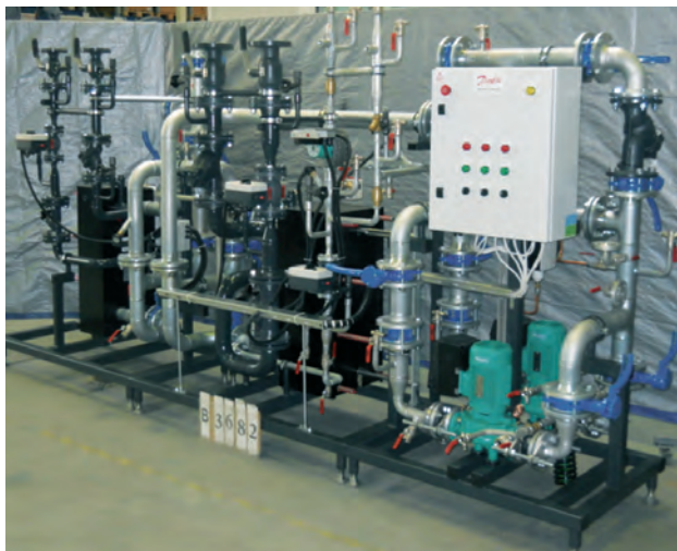
Рис. 43. БТП «Данфосс» с пластинчатыми теплообменниками
